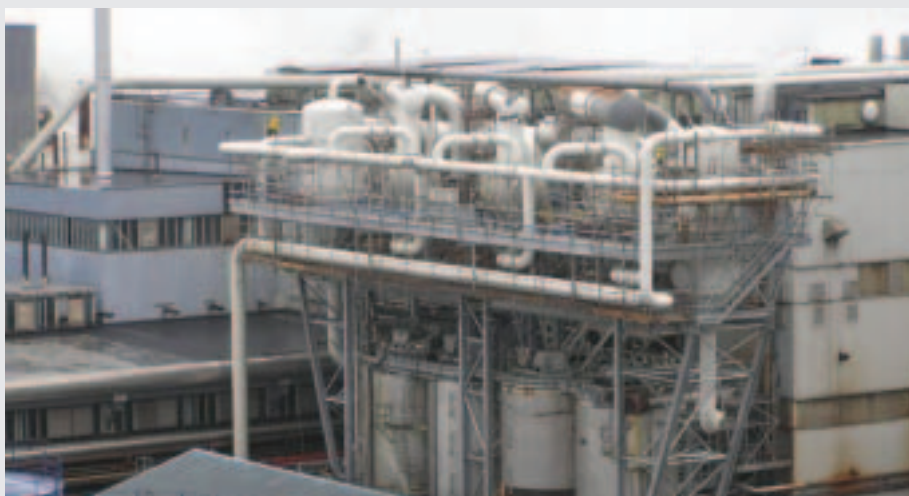
工厂屋顶的新平板蒸发加热器。
